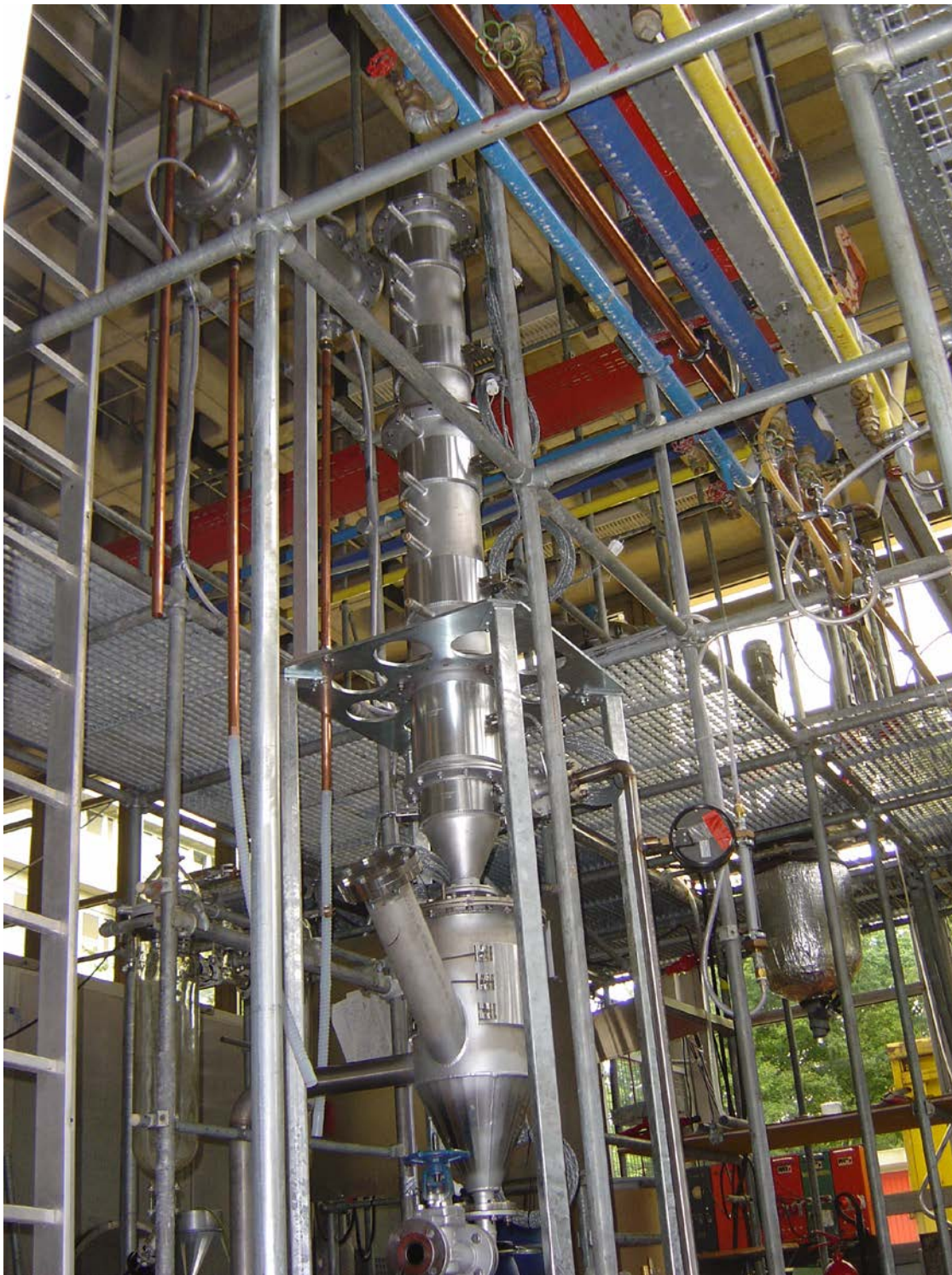
Abb. 15: Halbkontinuierliche 5 kg/h KDV-Technikumsanlage im Aufbau
